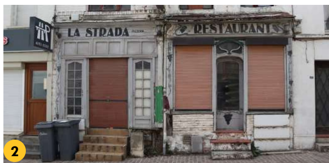
2 Devantures en applique en bois - Détail 'Art Nouveau'. Respect du parcellaire - Dénaturation par l'utilisation de volets roulants.
