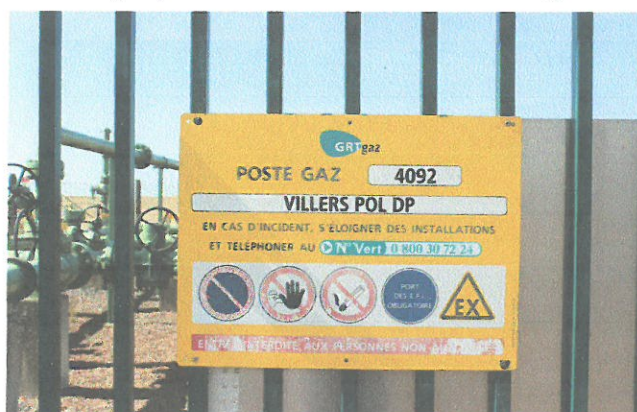
Photographie du site des vannes du gazoduc
