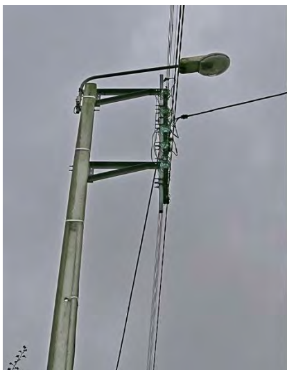
Luminaires routiers de la RD932
