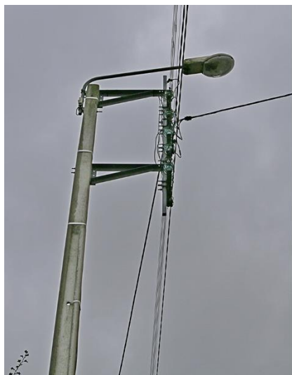
Luminaires routiers de la RD932
