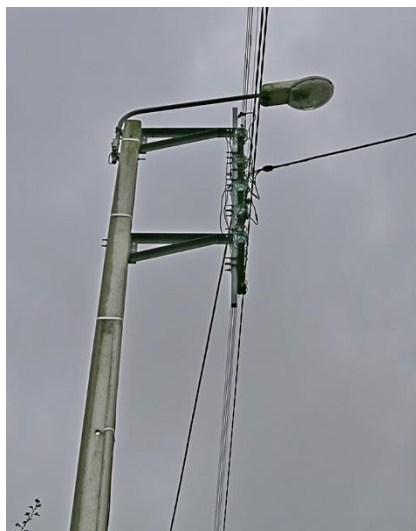
Luminaires routiers de la RD932
